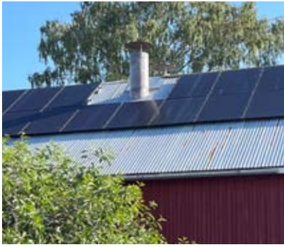
42 solcellspaneler har installerats på taket. Riktigt nytt.
