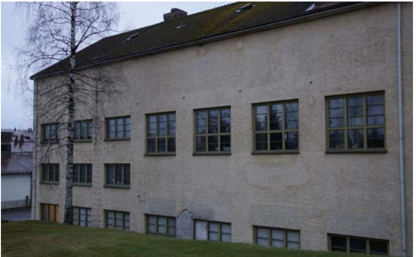
Muun muassa pohjoisjulkisivulla rappaus on kärsinyt. Katonrajasta poistetut ikkunat näkyvät vielä hennosti. Kuva Tengbom Eriksson Arkkitehdit Oy.
